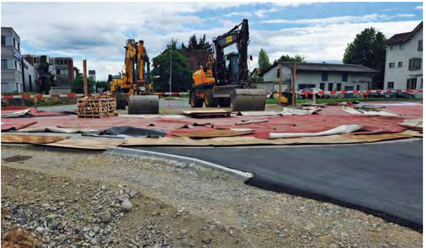
Kreisel 1. Etappe fertig erstellt, Kreisel wird mittels Gummimatten vor dem frühen Austrocknen geschützt
